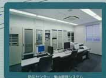
監視センター・集中管理システム
